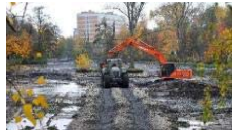
Ein Schotter-Damm musste extra mitten im Schwanenteich angelegt werden, damit der Schlamm gefahrlos abgefahren werden kann. Foto: Möller
